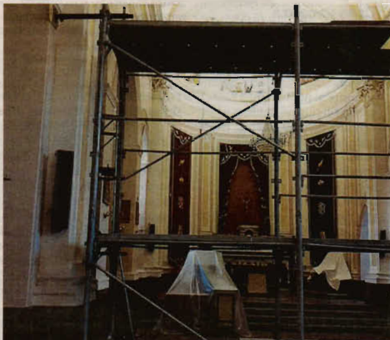
La chiesa di Sant'Anna. Il cantiere allestito con i soldi della manutenzione (*OC*)
