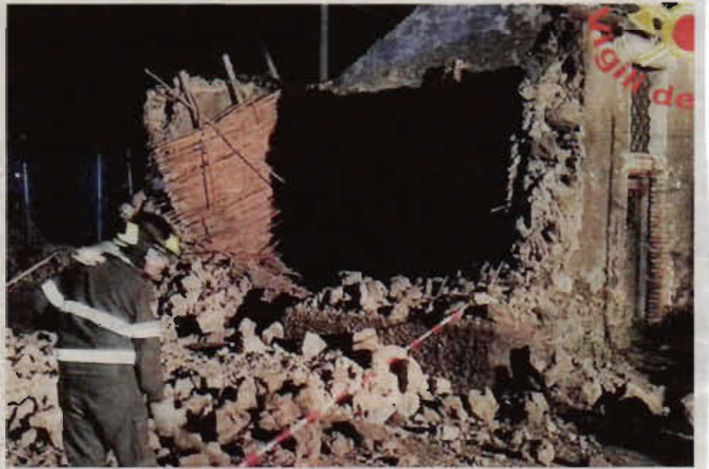
Sisma. Uno degli edifici crollati per la scossa registrata a Santa Maria di Licodia nell'ottobre scorso
