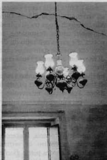
Sisma. Una delle case danneggiate
