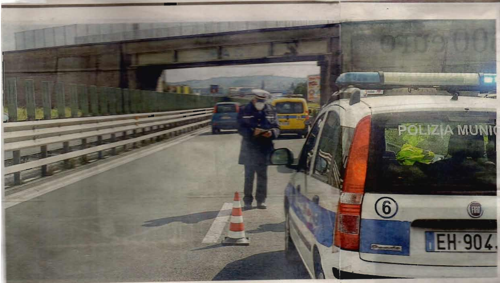
I danni subiti dal ponte sulla Statale 121 all'altezza di Etnapolis sulla Paternò-Catania
