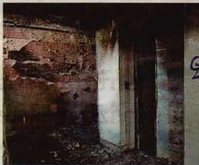
Il vano ascensore ormai incenerito
