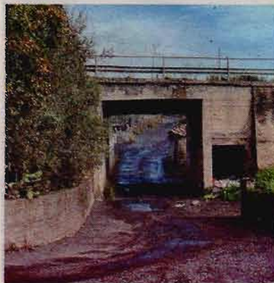
Il sottopasso di Paternò inadeguato
