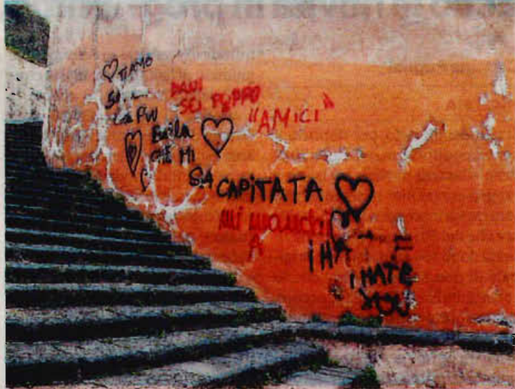
Vandali in azione. La scalinata settecentesca deturpata (*FOTO CARUSO*)
